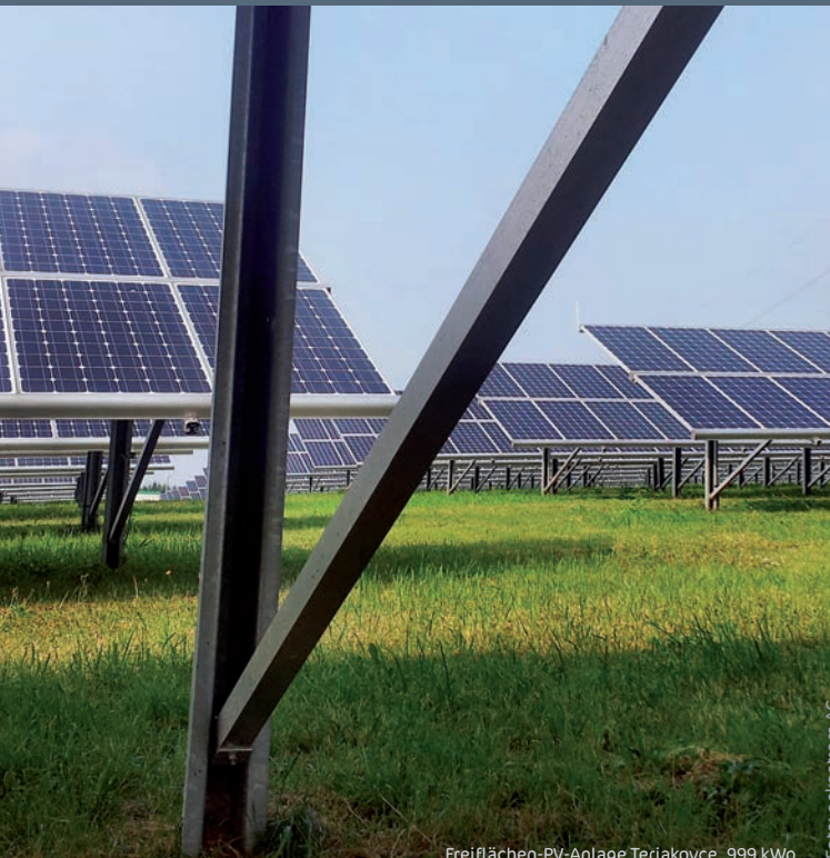
Freiflächen-PV-Anlage Teriakovce, 999 kWp
